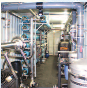
Meerwasserentsalzung mit Energierückgewinnung
