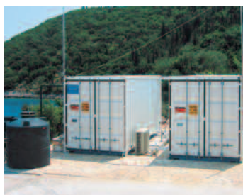
Meerwasserentsalzung in Containerbauweise
