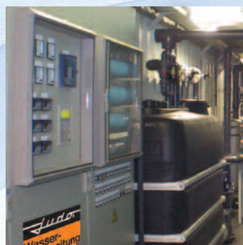
Schaltschrank Meerwasserentsalzung mit SPS
