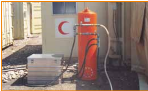
Wasseraufbereitungsanlage für ein mobiles Krankenhaus, Pakistan
