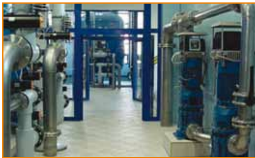
Trinkwasseraufbereitung im Wasserwerk 320 m 3 /h Wrzesnia, Polen
