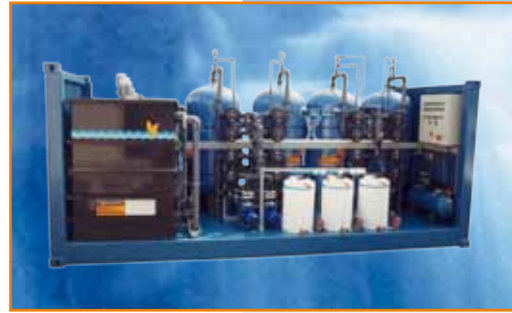
Seewasseraufbereitung Viktoria See, Nigeria
