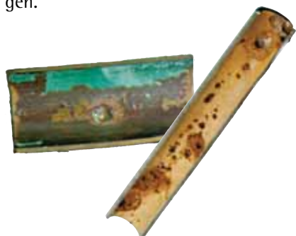
Lochkorrosion in ungeschützten Röhren
