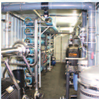
Meerwasserentsalzung mit Energierückgewinnung
