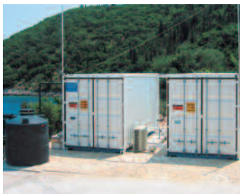
Meerwasserentsalzung in Containerbauweise
