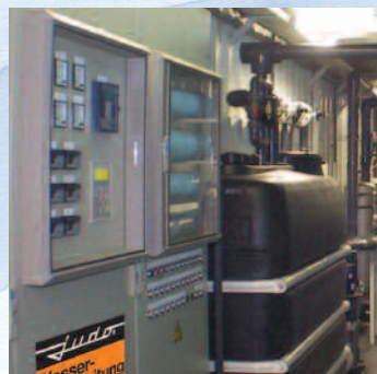
Schaltschrank Meerwasserentsalzung mit SPS
