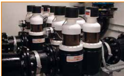
Trinkwasserfiltration durch mehrere JPF-ATP DN 200 City of Dreams Casino Resort Macao, China
