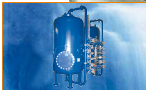
Enthärtungsanlage im Spital Luzern, Schweiz
