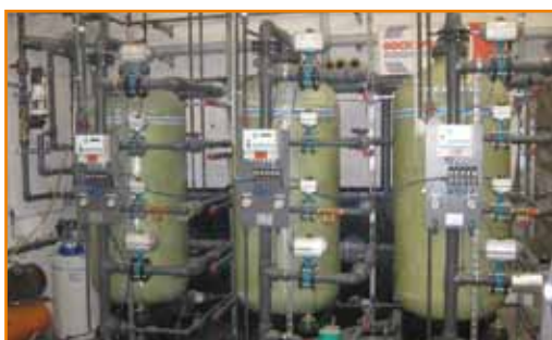
Enteisungsanlage für Brunnenwasser Molkerei, Berlin
