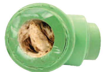
Unhygienisch: verkalktes Kunststoffrohr
