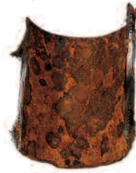
Korrosionen an einer Rohrleitung
